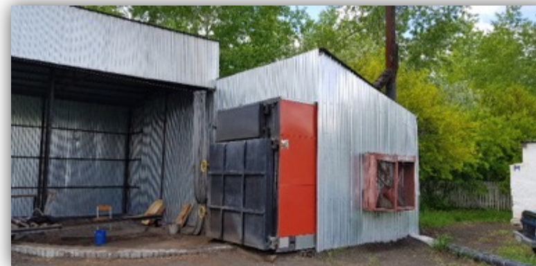
Новая модульная котельная на соломе
